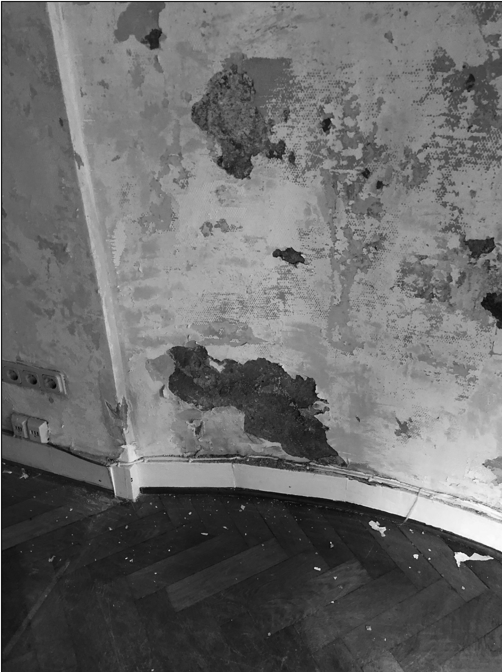
Abb. 1: Feuchteschaden hinter Leichtbauverkleidung mit asbesthaltigem Spachtel
