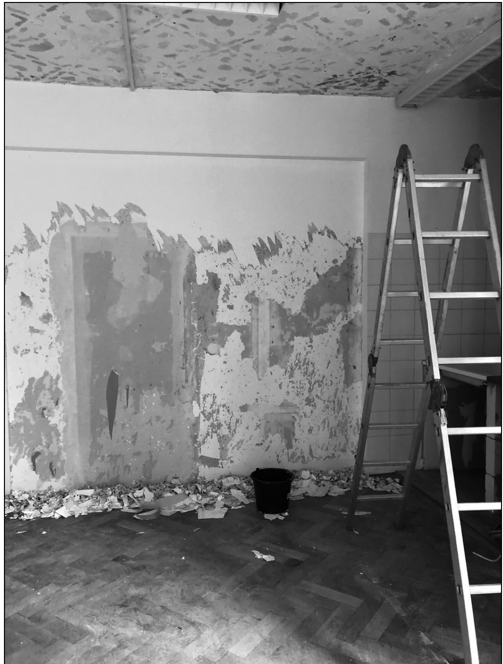
Abb. 2: Leichtbauverkleidung, dahinter massive Wand mit Feuchteschaden und Asbest
